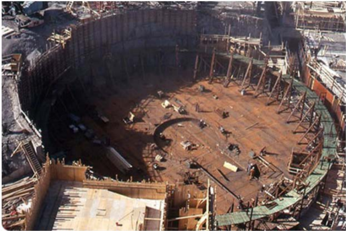
Viss korrosion härstammade från skador som åsamkats plåten redan under bygg tiden.
